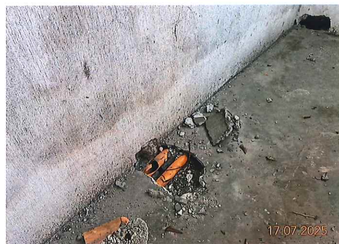
Evidencia de daños severos en sistema hidráulico de la construcción.
