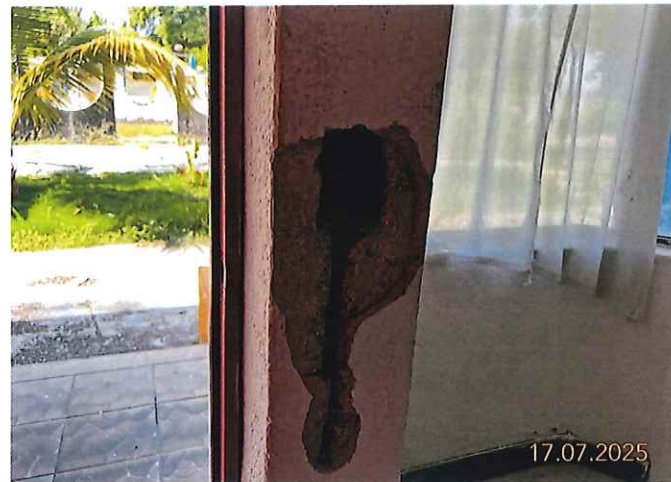
Detalle de espacio para caja electrica inexistente y daños en la pared.
