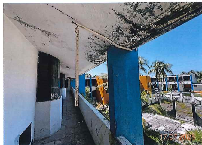
Pasillo de circulación del nivel 2. Evidencia de daños severos de humedad.
