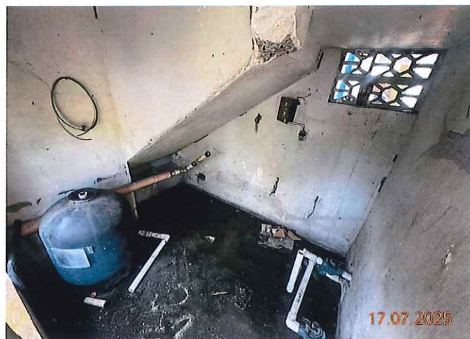
Bodega de bombas de la piscina.
