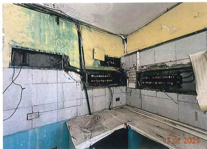
Área de tableros eléctricos.
